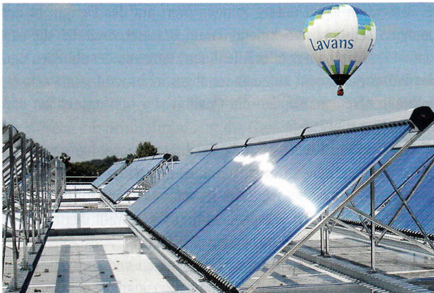
Solarkollektoren auf dem Dach der niederländischen Wäscherei Lavans sorgen für warmes Wasser.
